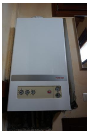
Piano Primo – Caldaia su scala
